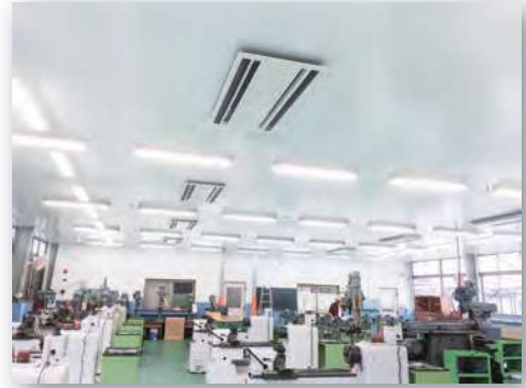
岡山県 津山工業高等専門学校 実習室
